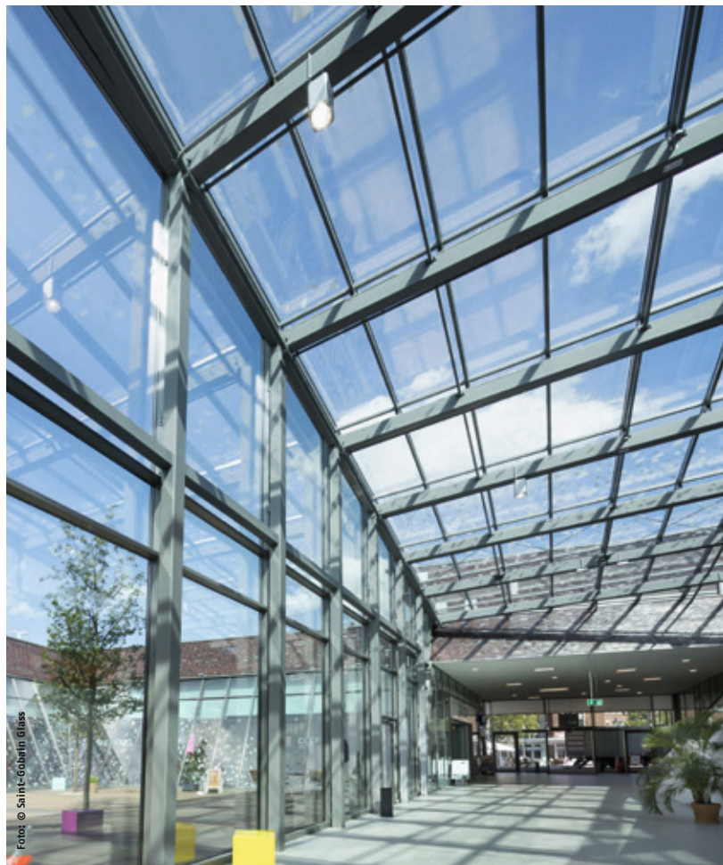
Foto: © Saint-Gobain Glas Überkopf-Verglasungen sind aus der modernen Architektur nicht mehr wegzudenken. Sowohl bei der Neuerrichtung als auch beim Austausch von beschädigten Gläsern müssen etliche Vorgaben beachtet werden.
